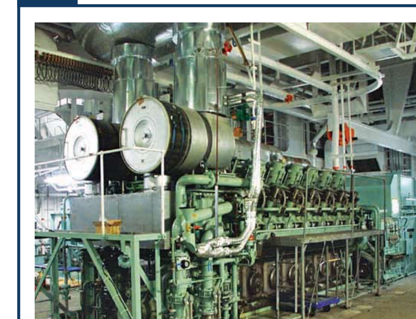
発電機で電気を作り、その電気エネルギー で船上の全ての装置を動かす
